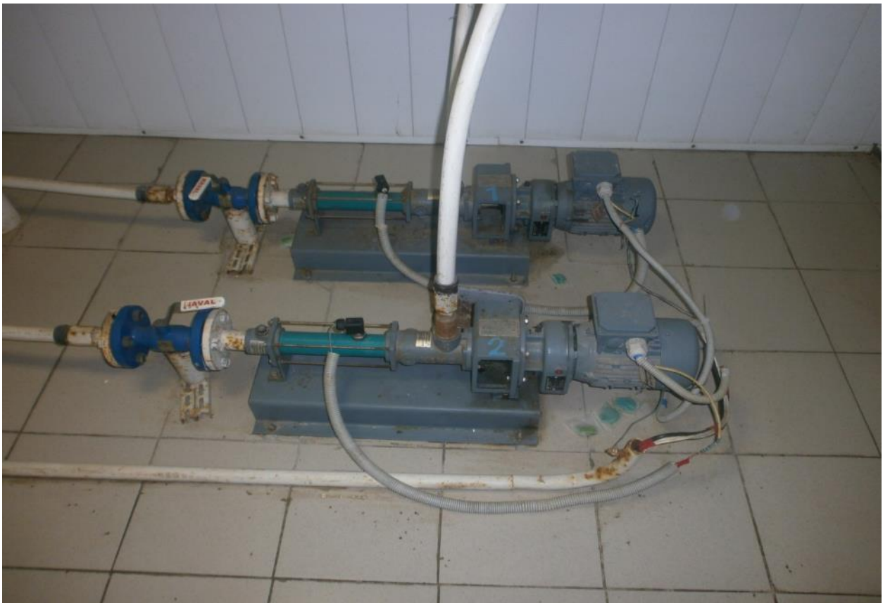
Рисунок 12-2. Станция приготовления раствора флокулянта на КОС 18 000 м 3 /сут.
