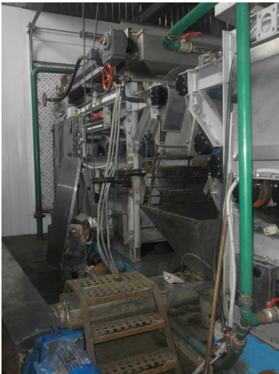
Рисунок 11. Блок подачи осадка на КОС 18 000 м 3 /сут.
