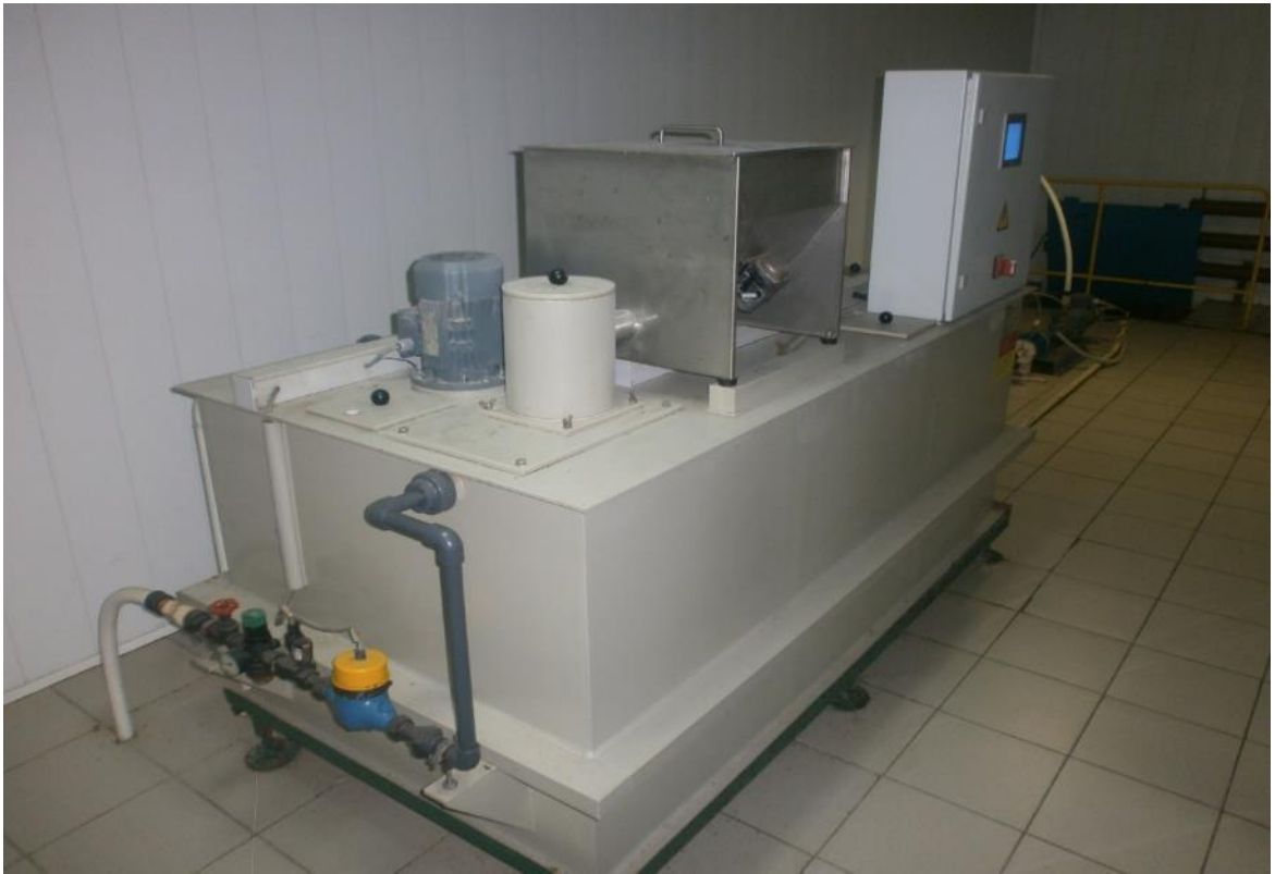
Рисунок 12-1. Станция приготовления раствора флокулянта на КОС 18 000 м 3 /сут.
