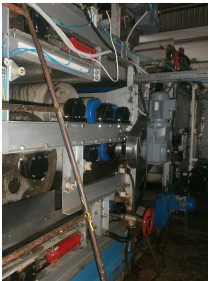
Рисунок 10. Цех механического обезвоживания осадков на КОС 18 000 м 3 /сут.
